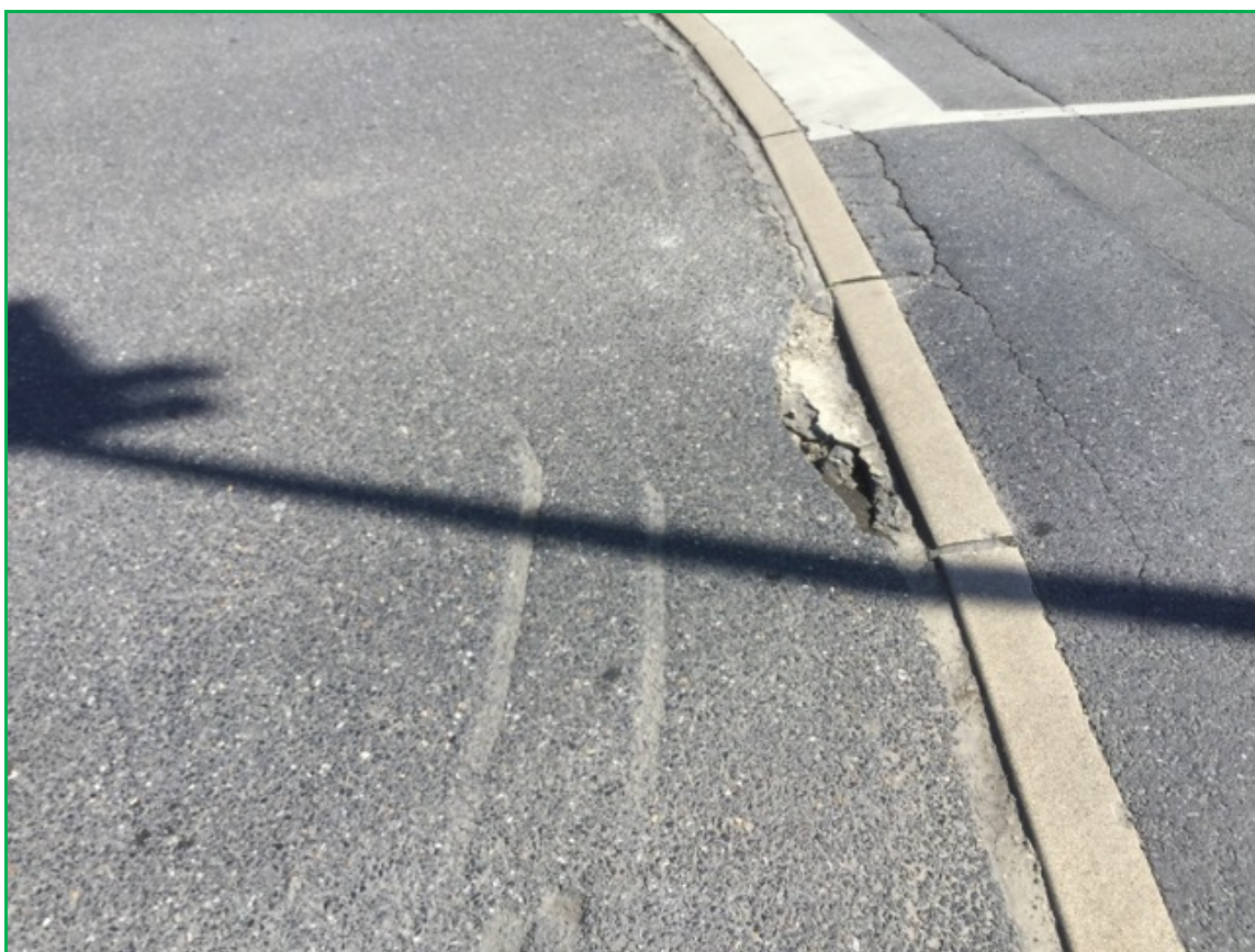
Purge à réaliser
