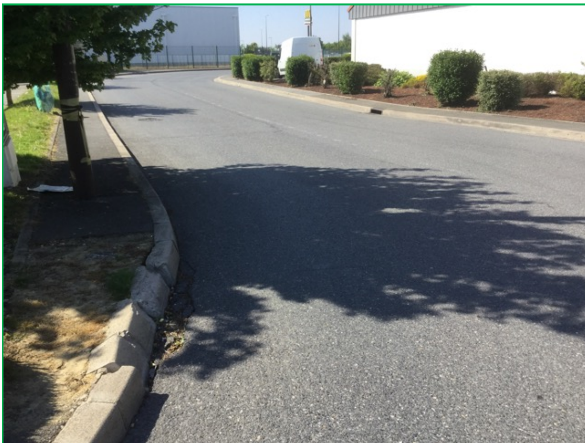
Bordures à remplacer
